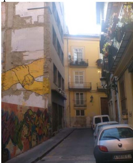
Deterioro del edificio
