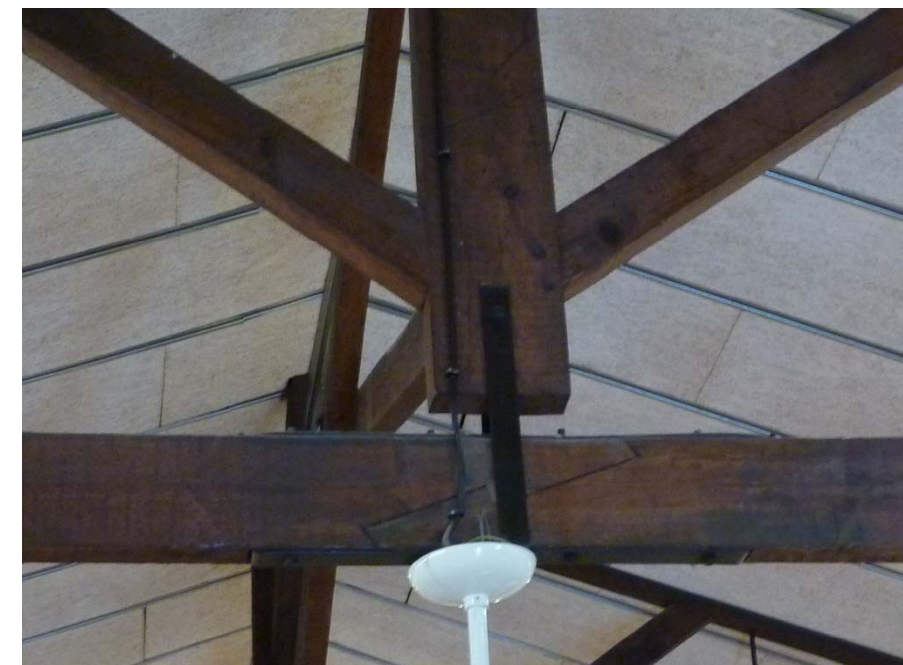
Detalle del nudo de la cercha entre el pendolón y el tirante
