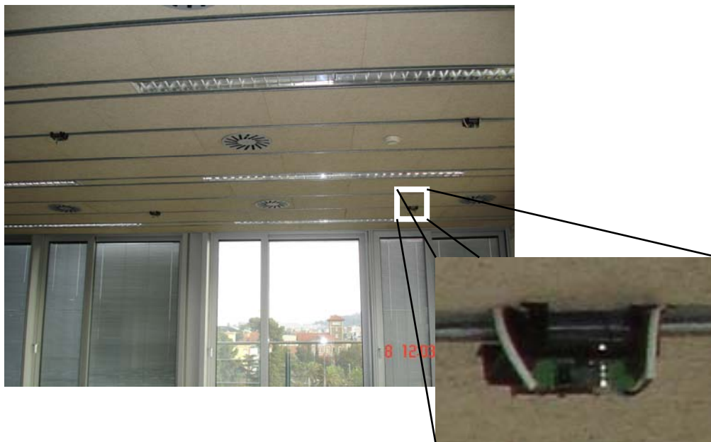
Figura 64. Instal·lació dels emissors a la sala Mirador
