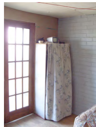
Imagen 6_Piso 2º /Balconera Dormitorio 3
