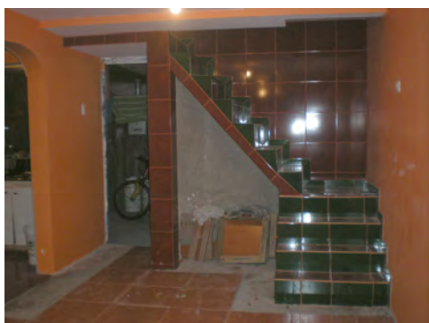
Caso de Estudio 18 Escala de hormigón armado y revestimiento de cerámica
