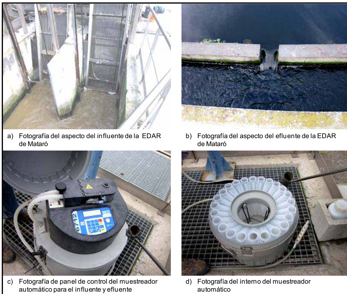
Figura 17. a) Influyente y b) efluente de la EDAR de Mataró y c) y d) equipo utilizado para realizar la recolecta de muestras compuestas
