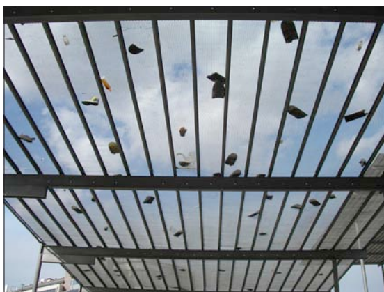
El techo de la marquesina de la Plaça dels Països Catalans se ha convertido en un cementerio de monopatines. Barcelona, 2005. Fuente: X. Camino.
