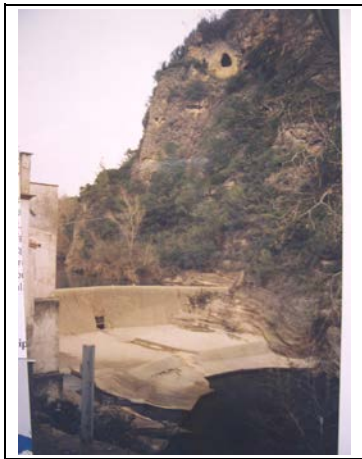
Foto 14.3. Resclosa de la central hidroelèctrica de Martís, des d'on es deriven les aigües per a la central hidroelèctrica del mateix nom.
