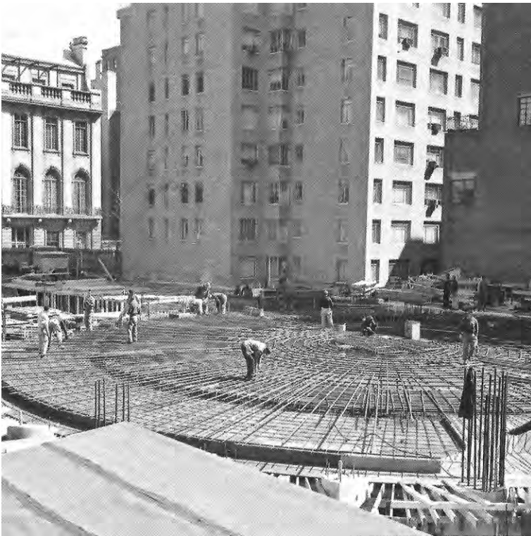
Fig. 3.9.2 En detalle, puede observarse una concentración del armado en la zona del centro de la circunferencia, en este caso en la cara inferior de la losa. Hay que señalar que la luz entre apoyos en este punto es de más de 18,5m, diámetro de la circunferencia que recoge los seis pilares del sótano, de los cuales puede verse el armado en primer plano.
