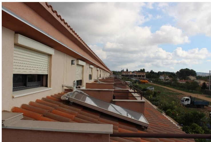
Figura 52: Plaques fotovoltaiques a la teulada d'una llar col·laborativa. Font: Pi (2021)
