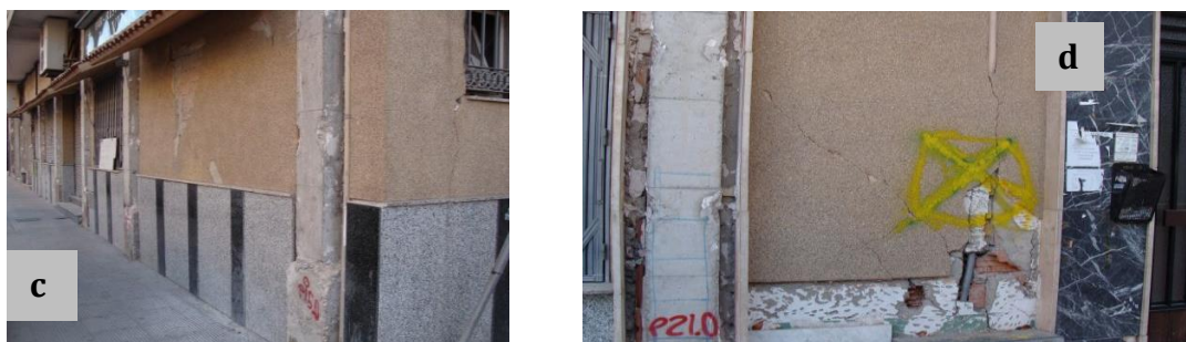
Figura 4-7: Edificio La Viña tras el terremoto de 11 de mayo de 2011 en Lorca (Murcia). a) Fachada orientada hacia el Este y posición del radar RAR durante las monitorizaciones del edificio; b) Fachada orientada hacia el Norte. Se aprecia ausencia, por caída, del parapeto a nivel de cubierta; c) Planta baja en su orientación Este. Se aprecian daños en los cerramientos; d) Planta baja orientación Norte. Daños en los cerramientos y detalle de soporte
