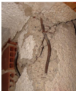
Figura 5-11: Edificio San Fernando -bloque 11- (Lorca). Falla por aplastamiento y pandeo del acero longitudinal
