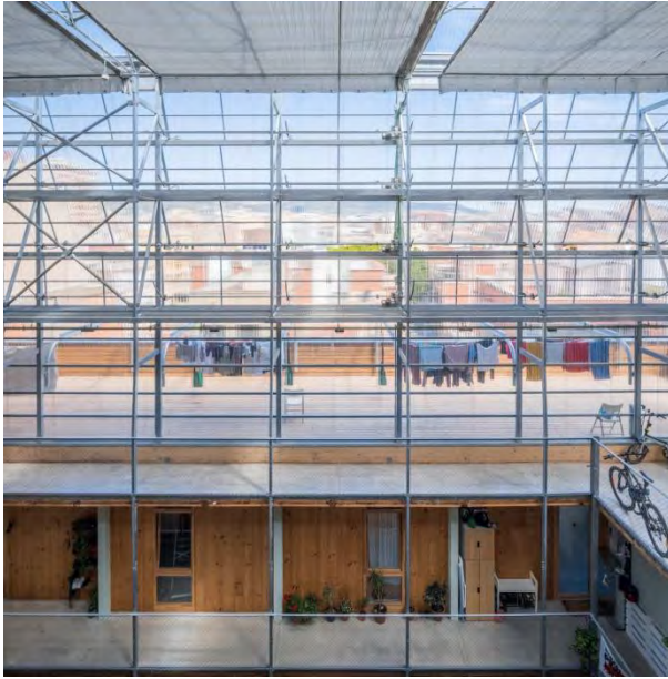
Fig. 149 - Lamas de ventilación y toldos horizontales automatizados de la planta sexta
