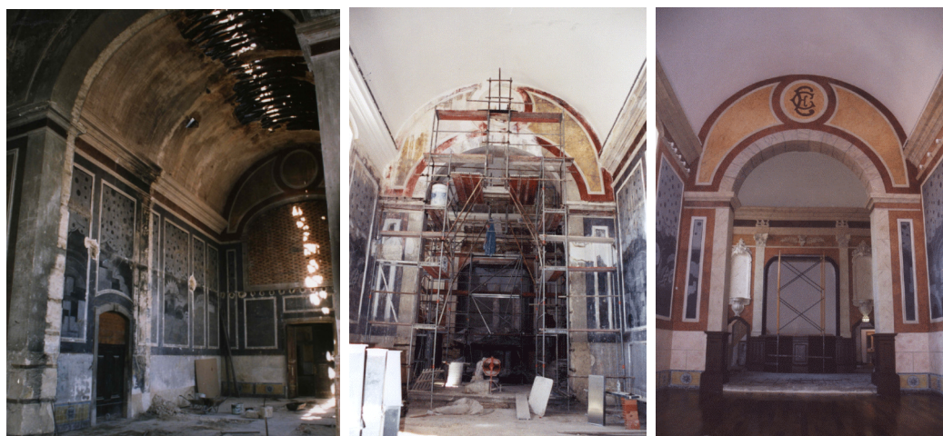
Fig. 81, 82 y 83. Imágenes de la iglesia, antes de la intervención, durante las obras y estado actual.
