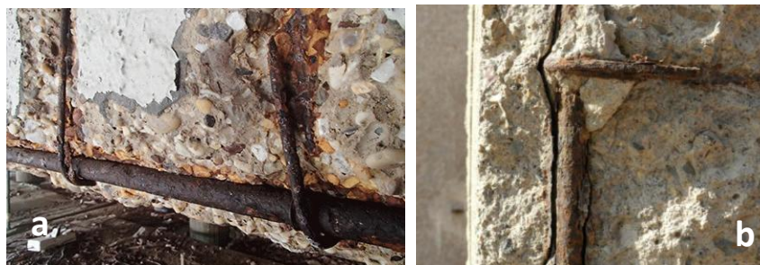
Figura 3.2.5. Daños por corrosión a) reducción de la sección del acero, b) pérdida de adherencia acero- hormigón.
