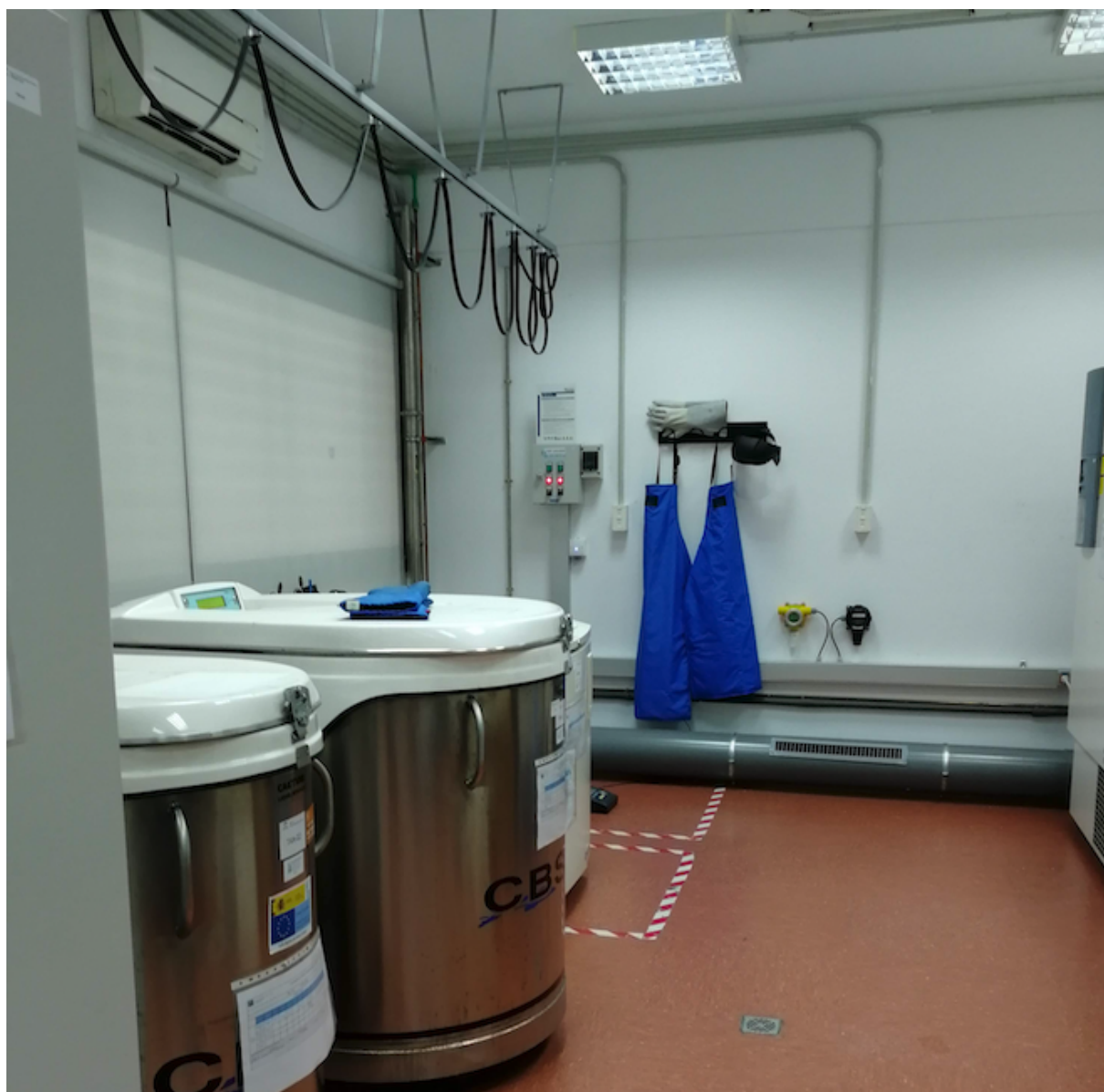
Figura 8.6: Sala de un biobanco. Mandiles, guantes, aire acondicionado, cableado, pantalla protectora, alarma, control de presión, interruptor, desagüe, tuberías, termostato.
