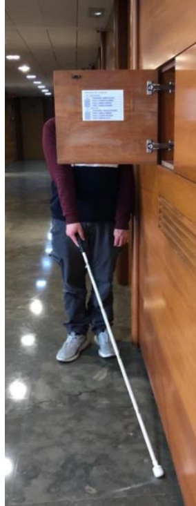
Figura 1. Falta de detección de un obstáculo a la altura de la cabeza.
