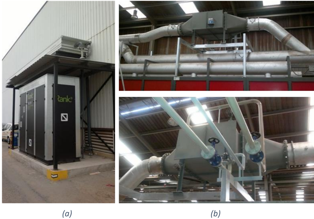
Figura 5.1: Instalación experimental (a) vista exterior de la unidad ORC, (b) punto en el que se aprovecha el calor residual (fuente Peris, 2017 55 ).
