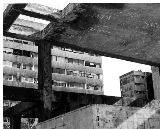
Imágenes 186, 187, 188, 189, 190 y 191. Abandono y deterioro, 1980-1990. Fuente: Arxiu Històric del Camp de La Bota i La Mina.
