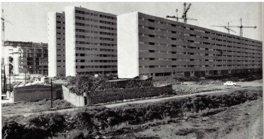
Imágenes 101 y 102. Construcción de los bloques Estrellas y Levante, 1972-1974 . Fuente: Arxiu Històric del Camp de La Bota i La Mina . Cedidas por el Patronato Municipal de la Vivienda.
