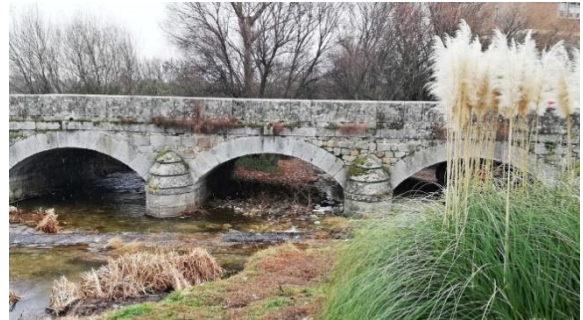
Figura 6.12. Puente del Rosario construido con sillares de granito encajados entre sí, en Guadarrama.
