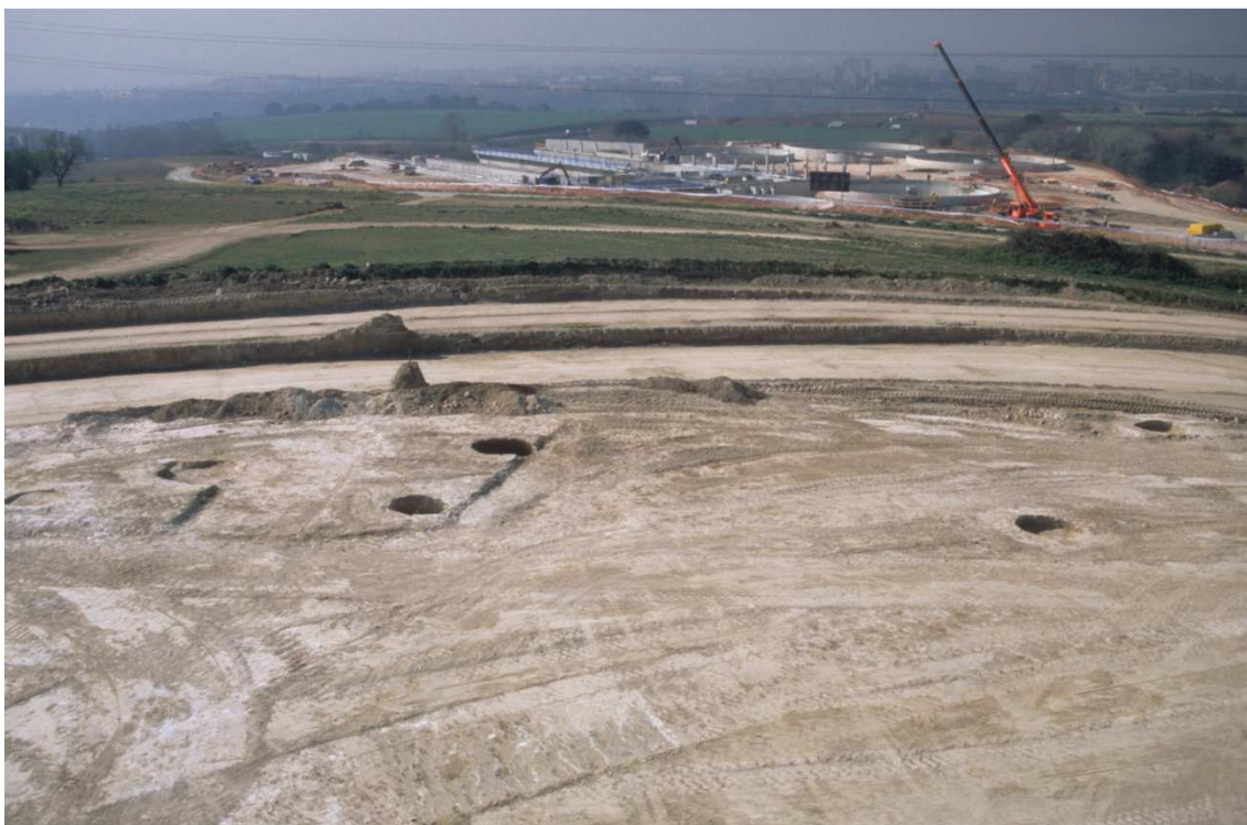
Fig.39.- Construcció de l'EDAR Sabadell - riu Ripoll (1999-2000). Des de Can Roqueta II. Crèdits: Equip CR-II.
