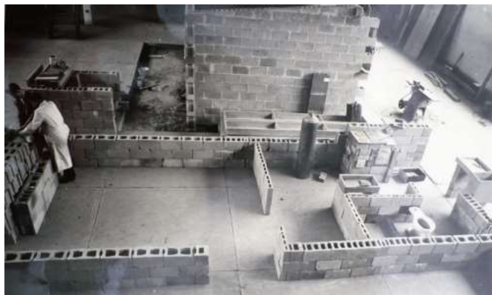
Figura 119. Barrio Quiroga, verificación a escala natural de dimensiones y ensamble. Fuente: CINVA (1956), Desarrollo de un tipo urbano de vivienda económica (Inf. final).
