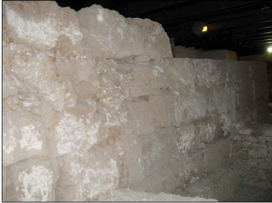
Fig. 143: Fotografía de la muralla de la fase II de Palermo donde se pueden observar los grandes bloques de piedras, apenas sin trabajar, calzados con ripios (Foto autor).
