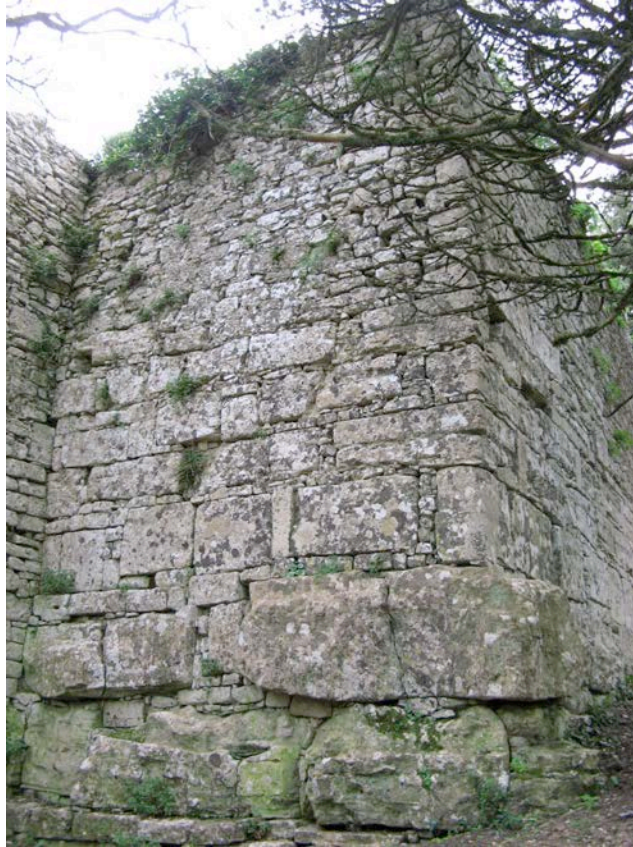
Fig. 21: Torre nº 4 del sistema defensivo de donde se aprecian claramente los dos aparejos constructivos empleados durante su fase I -megalítico- y su fase II -rectangular "isódomo"- (Foto autor).
