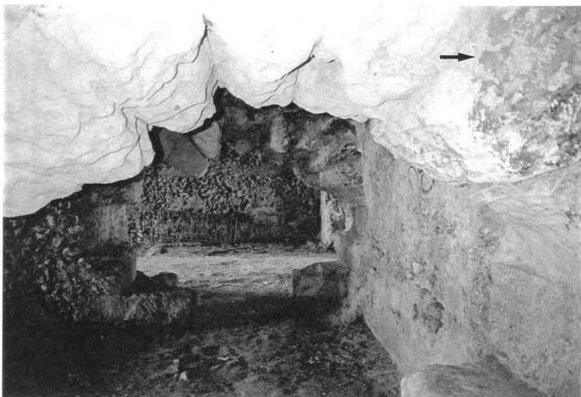
An-8/26.F-1 Anfiteatro Romano, sector A. Costra negra en las arcadas de acceso a la "Caved"
