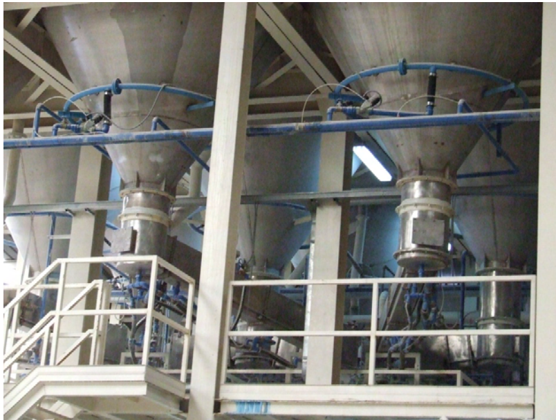
Figura 7 Distribució de material des de sitges fins la mescladora.
