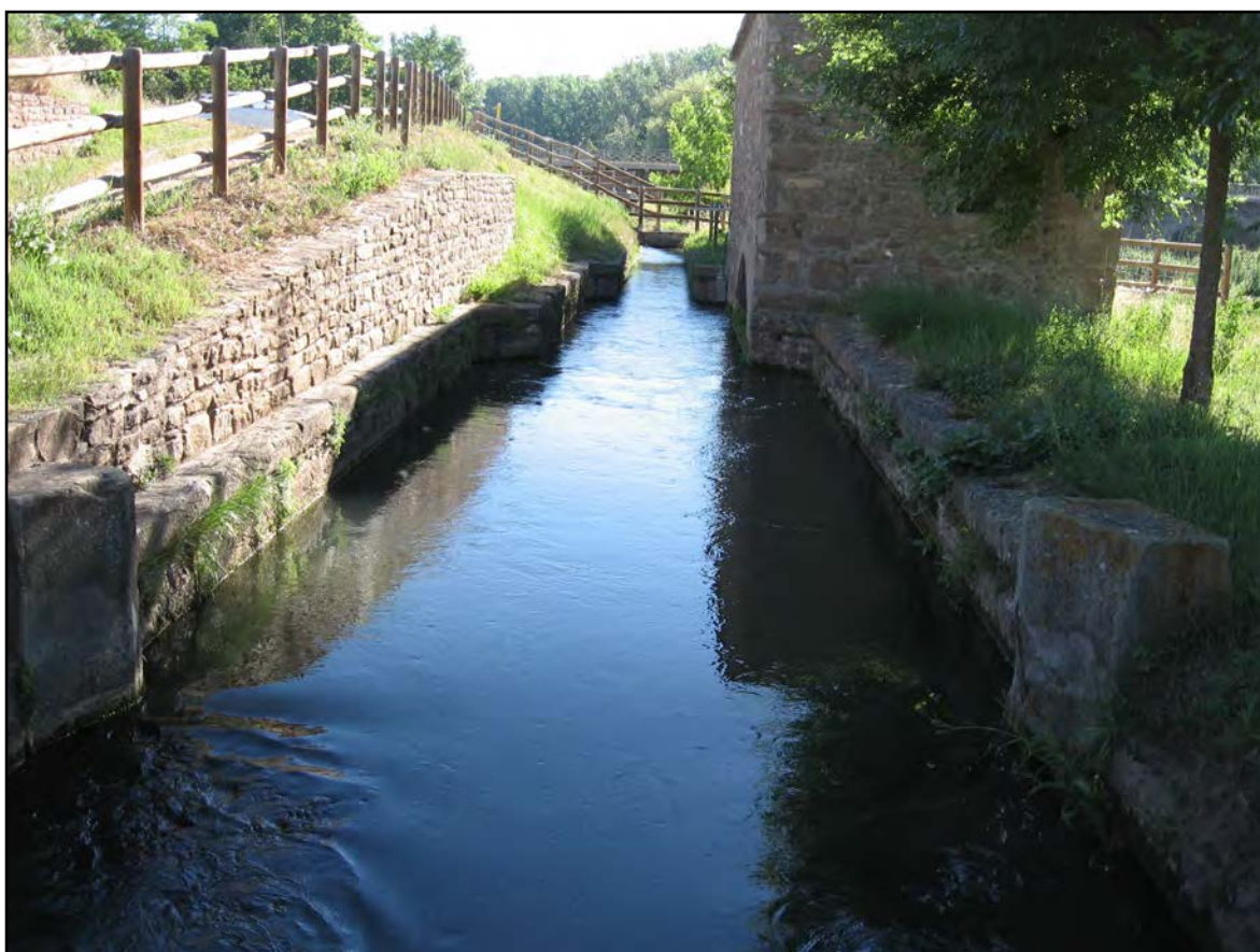
Figura 4.7. Estructura del Mòdul Hidromètric que es conserva avui dia com l'original. Es pot observar les llindes que delimitaven el vessador central, actualment desmantellat. Imatge presa el març de 2016.
