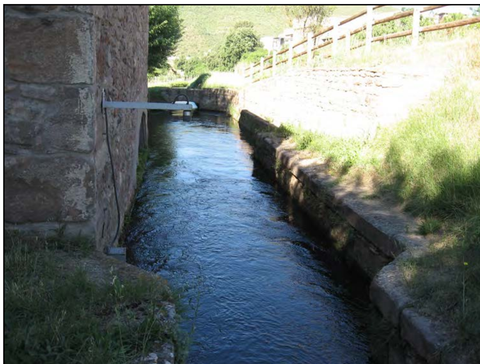
Figura 4.9. Vista general del l'estructura del Mòdul des de la seva entrada. A l'esquerra de la imatge hi ha l'edifici que acull els dipòsits de regulació. Sobre la paret de l'edifici hi ha situat un sensor de nivell. Imatge presa el març de 2016.
