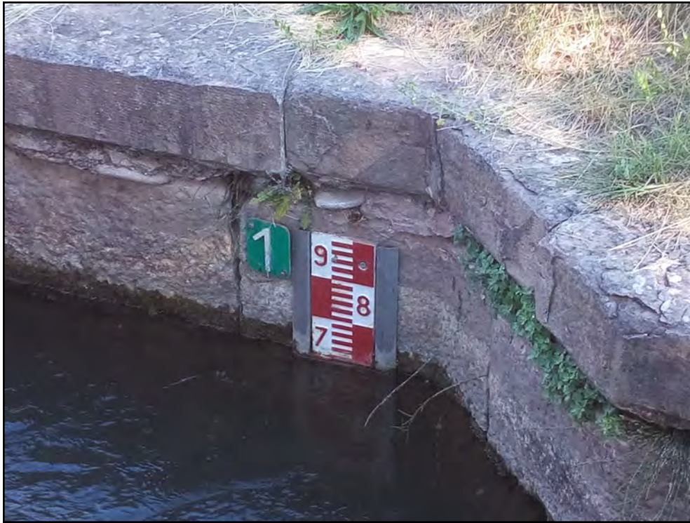
Figura 4.11. Detall d'una regla limnimètrica situada en una de les parets de l'estructura del Mòdul Hidromètric. Imatge presa el març de 2016.
