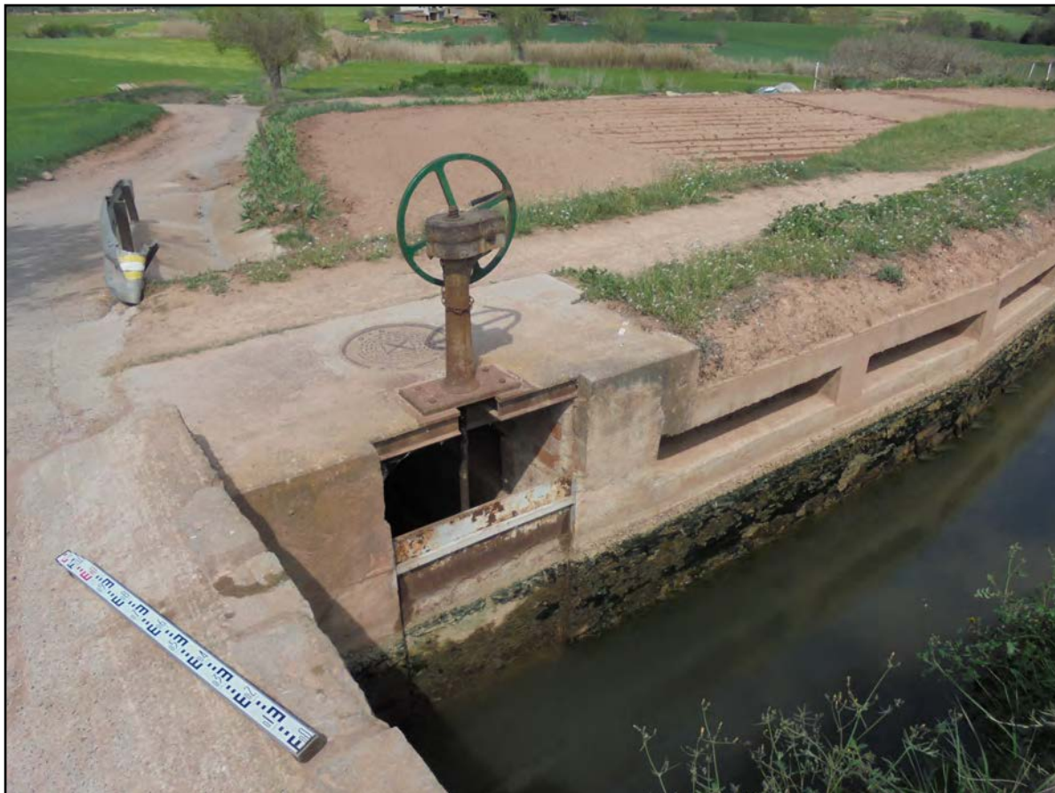
Figura 1.45. Bagant d'època moderna format per comporta rectangular metàl·lica amb accionament per manivela amb reductor mecànic. Fotografia presa el maig de 2016.
