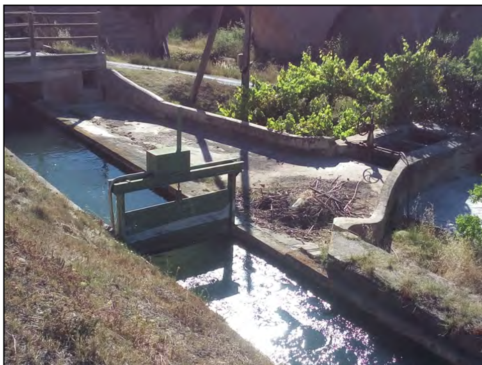
Figura 4.10. Bagant de derivació de l'excés de cabal accionat per motor elèctric i comandat a distància. Imatge presa el març de 2016.
