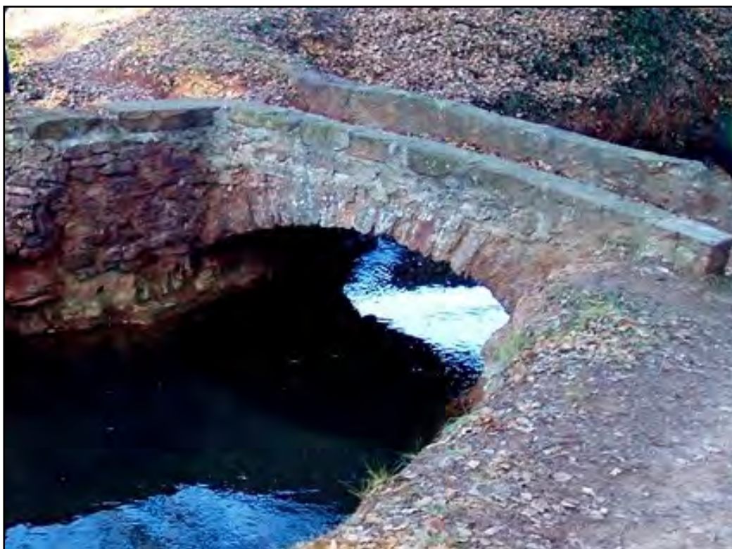
Figura 1.41. Pontarró que canalitza aigües pluvials per evitar que aquestes acabin dins la Sèquia. Font: http://1.bp.blogspot.com/-hrL6Dp6lSeM/T1YpbmOGS9I/AAAAAAAAATgo/zvsNL-Sju9G8/s1600/P1010127a-1.JPG . Data d'accés: 09/03/2016.
