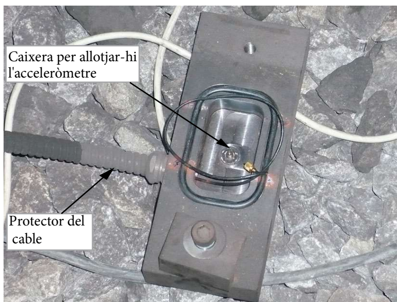
Figura 7.5: Suport metàl·lic on es munta l'acceleròmetre. Posteriorment s'instal·la a sota del patí del carril. [6]
