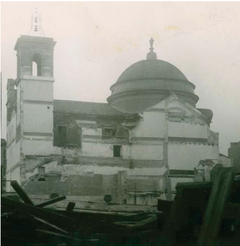
Il. 31. Juan Ramírez, Detall de la façana dreta de l'església de Sant Sever i Sant Carles Borromeu durant l'enderroc de l'hospital militar, 28-III-1943. AFB, C-038-185
