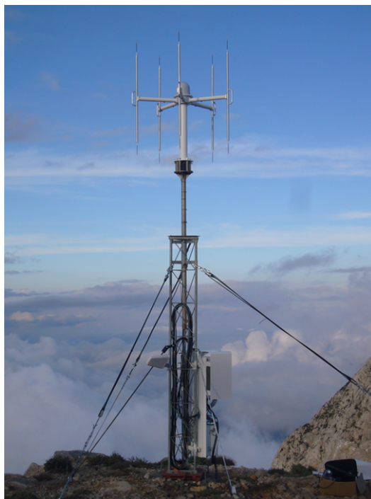
Figura 2.5: Exemple de detector instal·lat en la XDDE. Font: Lightning Research Group (LRG) de la Universitat Politècnica de Catalunya (UPC).
