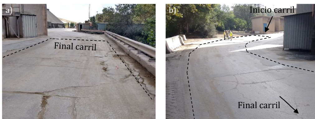
Figura 6.3 – Estado previo de la zona donde se ejecutó la Experiencia 1: detalles del inicio (a) y del final de la zona (b).
