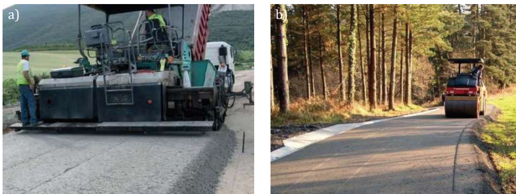
Figura 2.11 – Construcción de los HCCR: extensión del hormigón (a) y compactación (b) (IECA, 2016).
