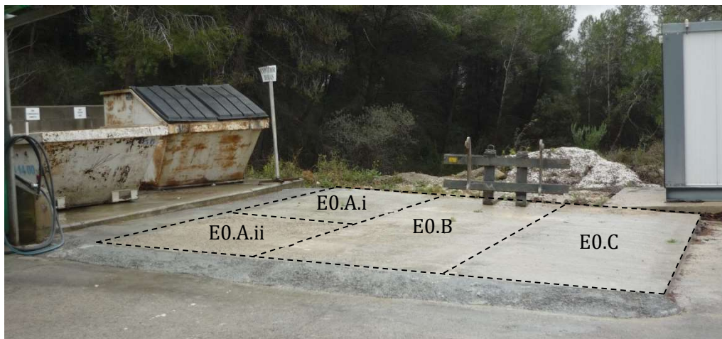
Figura 5.13 – Aspecto del pavimento de la Experiencia 0.
