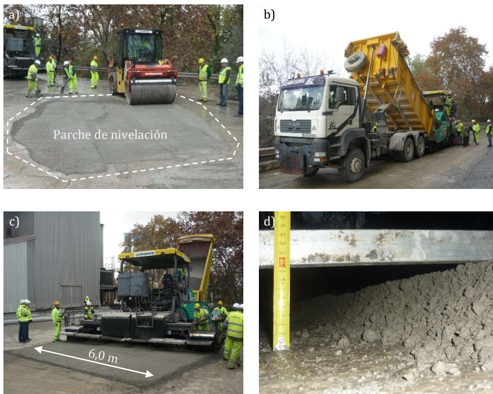
Figura 6.7 –Parcheado de los baches del pavimento original (a). Vertido del hormigón sobre la tolva de la extendedora (b). Extensión del hormigón (c). Espesor final tras compactación (d)
