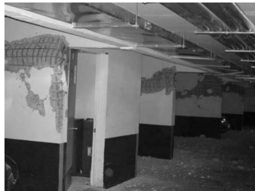
(b) Daños en los muros del aparcamiento
