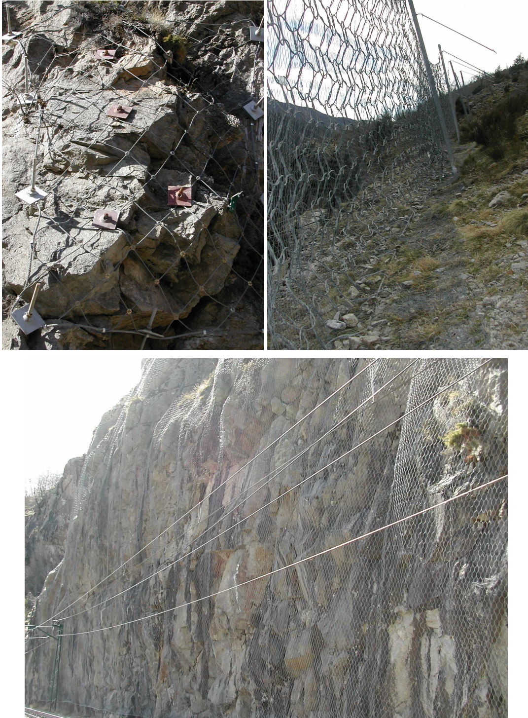
Figura 8.3: Diferentes medidas de protección de la vía del tren cremallera instaladas para disminuir el riesgo de desprendimientos al pie de la pared del Roc del Dui.
