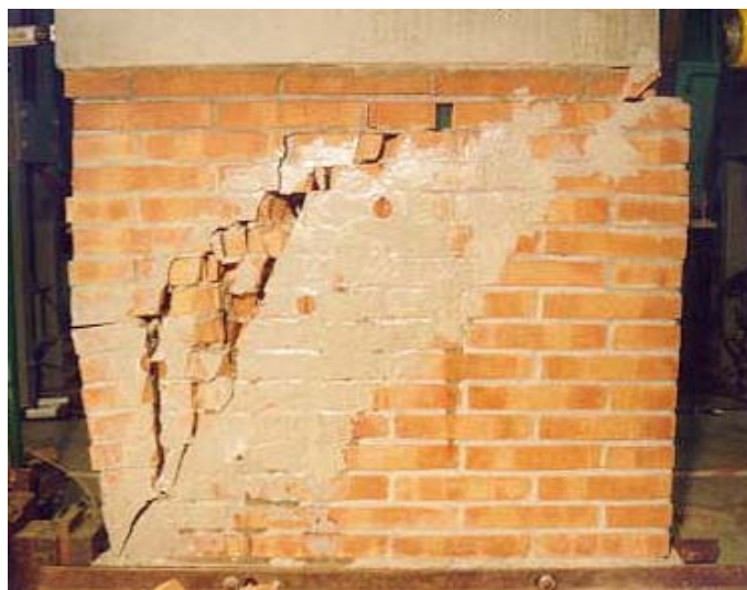
Figura 4.13 — Rotura del panel 6.
