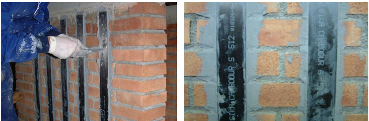
Figura 3.44 — Aplicación del laminado de fibra de carbono sobre uno de los paneles: (a) fijación de los laminados; (b) detalle del trabajo terminado
