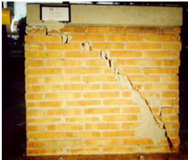
Figura 4.5 — Rotura del panel 2.
