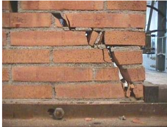
Fig. 3.14 — Detalle de fisura en uno de los paneles intactos (Sánchez, 2001).
