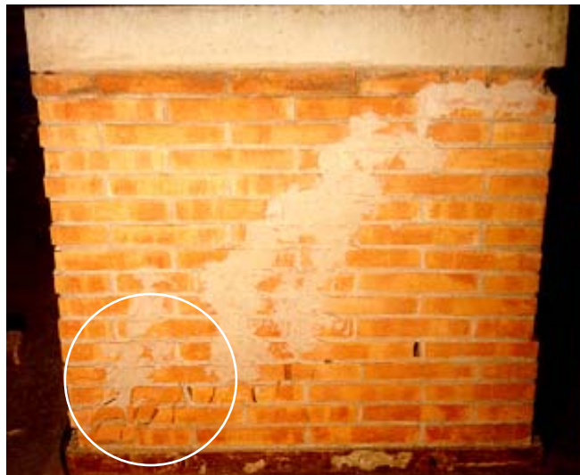
Figura 4.11 — Rotura del panel 5.
