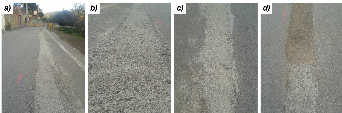
Figura A2. 120 – Aspecto del hormigón días después de la prueba; a) vista general; b), c) y d) detalles de la zanja
