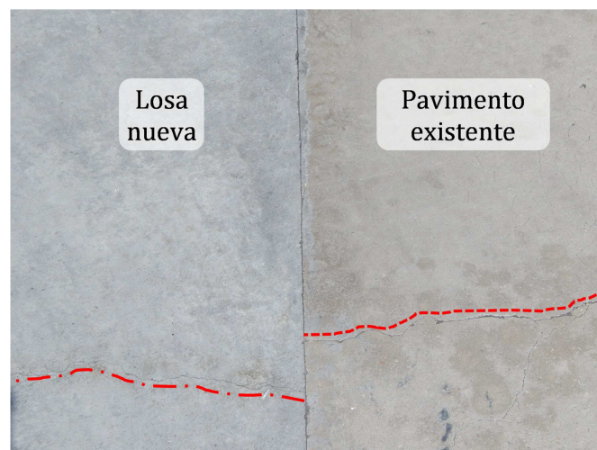
Figura A2. 55 – Fisura continua entre pavimento nuevo y existente
