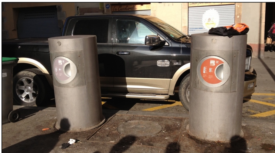
Figura 2.11: Buzón de acceso para la recogida por succión neumática.
