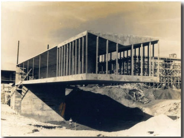
37. Fotografía de la construcción del Mausoleo del General Castelo Branco. La gran viga central acartelada de hormigón armado asume el gran vuelo estructural del Mausoleo. Fuente: Ídem
