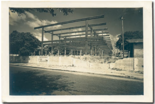
32. Fotografía de la secuencia de pórticos estructurales construidos con dobles tubos de acero del Palacio de gobierno. Fuente: Ídem.
