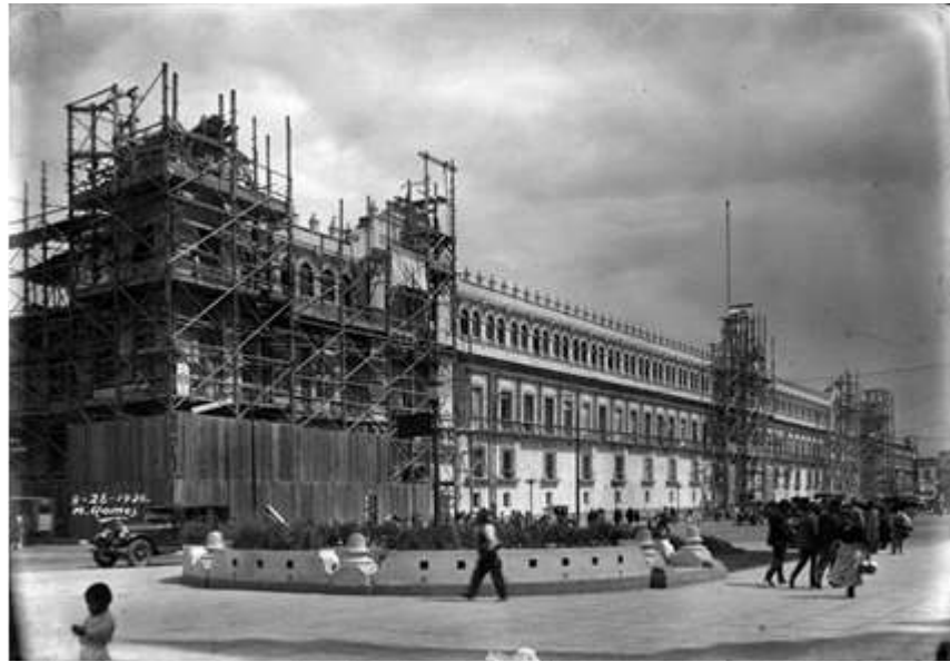
Foto del Palacio Nacional, durante las obras que refiere Artemio de Valle Arizpe, emprendidas bajo la anuencia del arquitecto Alberto J. Pani y a cargo de los arquitectos Ortiz Monasterio y Augusto Petricioli. La foto tiene la fecha agosto 28 de 1926 y el nombre M. Ramos. Se puede observar que han añadido el tercer nivel. Abajo, la fachada principal del Palacio ya reformada (Fotos: de la Fototeca nacional-INAH, México).
