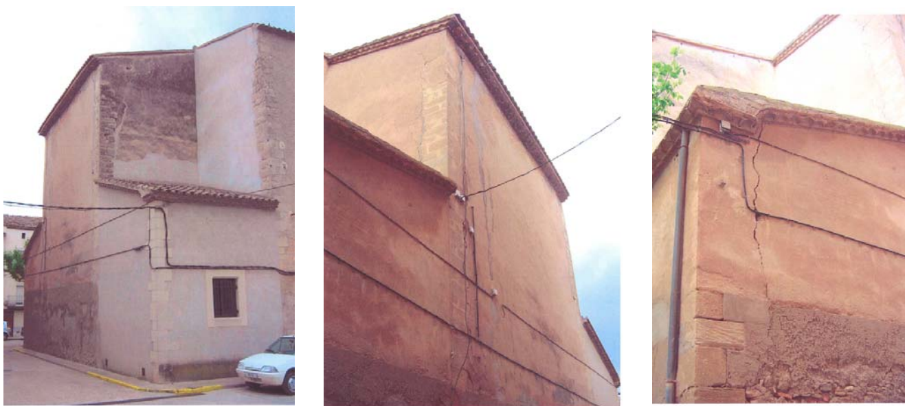
Fig.4 Fotografies de les lesions exteriors de l'església. Font: Sala Consultors SL, 2006. Facilitat per l'arquitecte Ramón Padullés.
