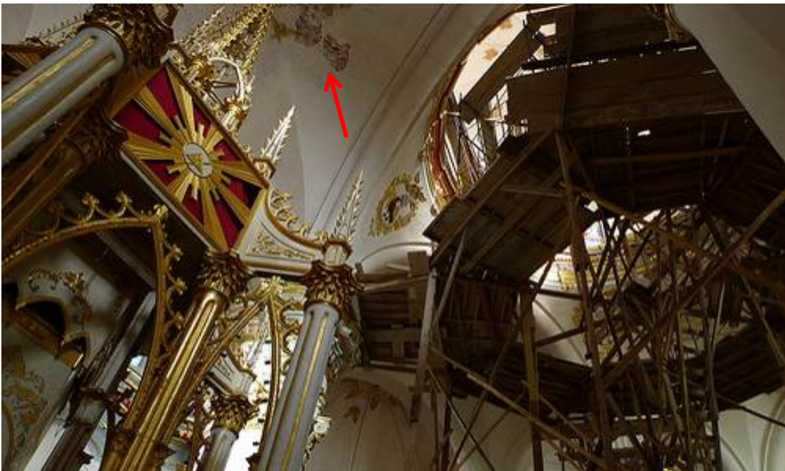
Fig.232 Fotografies de la Catedral de Potosí en obres. S'evidencia l'existència de maons.
