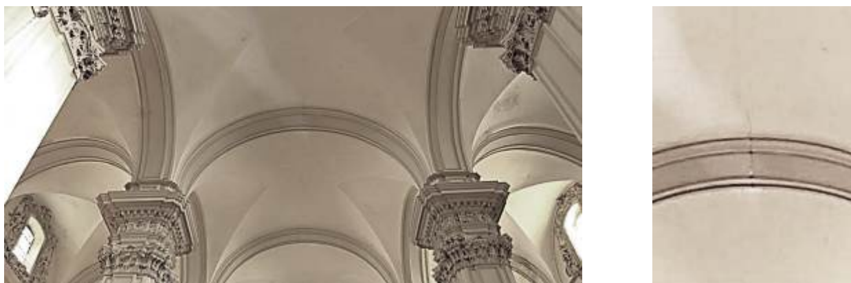
Fig. 95 Interior de la nau d'Alcañiz, agost 2015. Esquerdes a la clau de l'arc que es prolonguen lleument cap a la volta.
