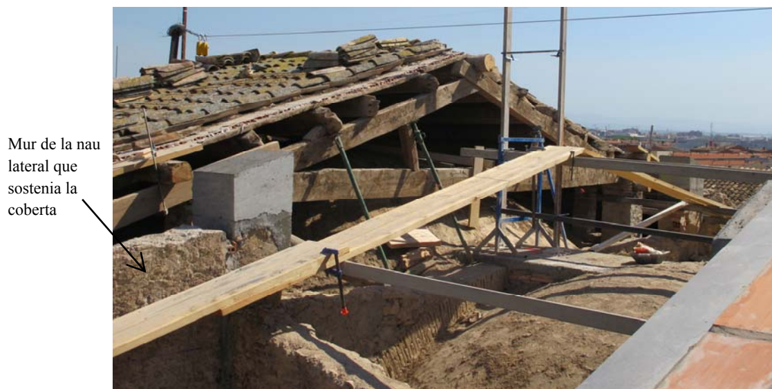
Fig.36 A la fotografia es veu clarament com el mur de la nau lateral arribava a sostenir la coberta. També s'aprecien les modificacions realitzades al llarg dels anys. Fotografia cedida per Ramon Padullés.
