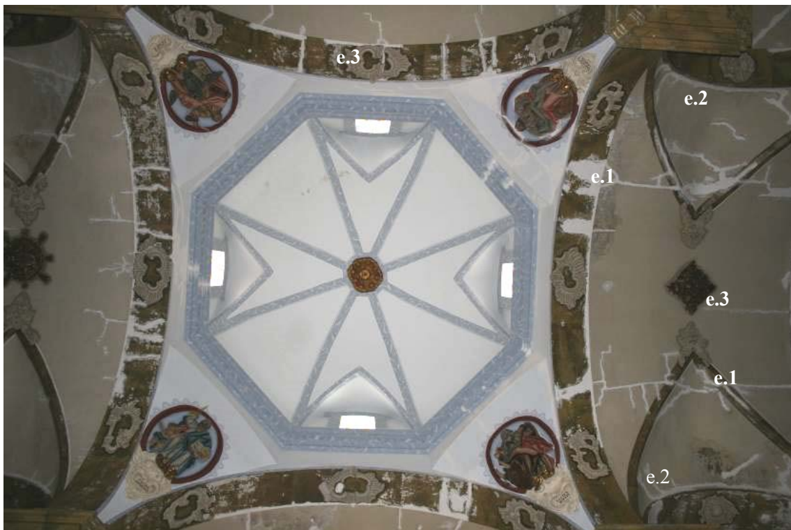
Fig.10 Fotografia actual. Esquerdes de Sabouret (e.1), esquerdes del mur (e.2) i esquerdes a la clau (e.3). La resta d'esquerdes no responen a un patró establert, són anàrquiques i exteses a tota la nau, tant als murs com a les voltes i arcs, no tant als pilars.
