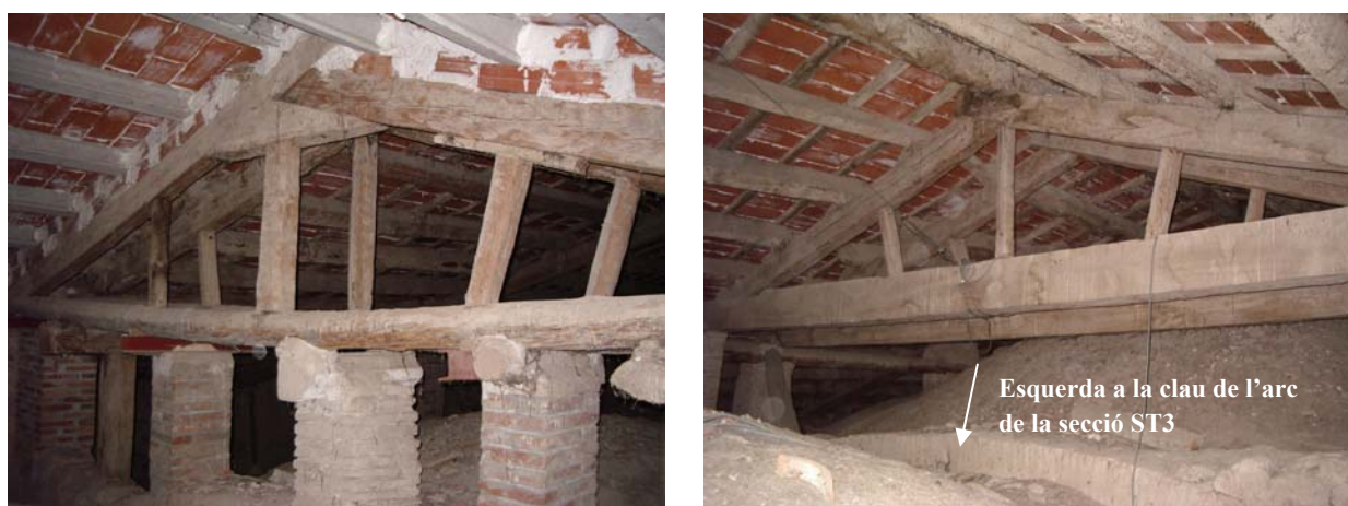
Fig.19 A l'esquerra es mostren les pilastres sobre l'arc de la secció ST4. A la dreta es mostra la secció ST3, on no hi havia pilastres que recolzaven sobre l'arc. Al centre d'aquest darrer arc s'observa l'esquerda situada a la clau que disminueix fins a desaparèixer a mesura que s'acosta a l'extradós. Fotografies proporcionades per Ramon Padullés.
