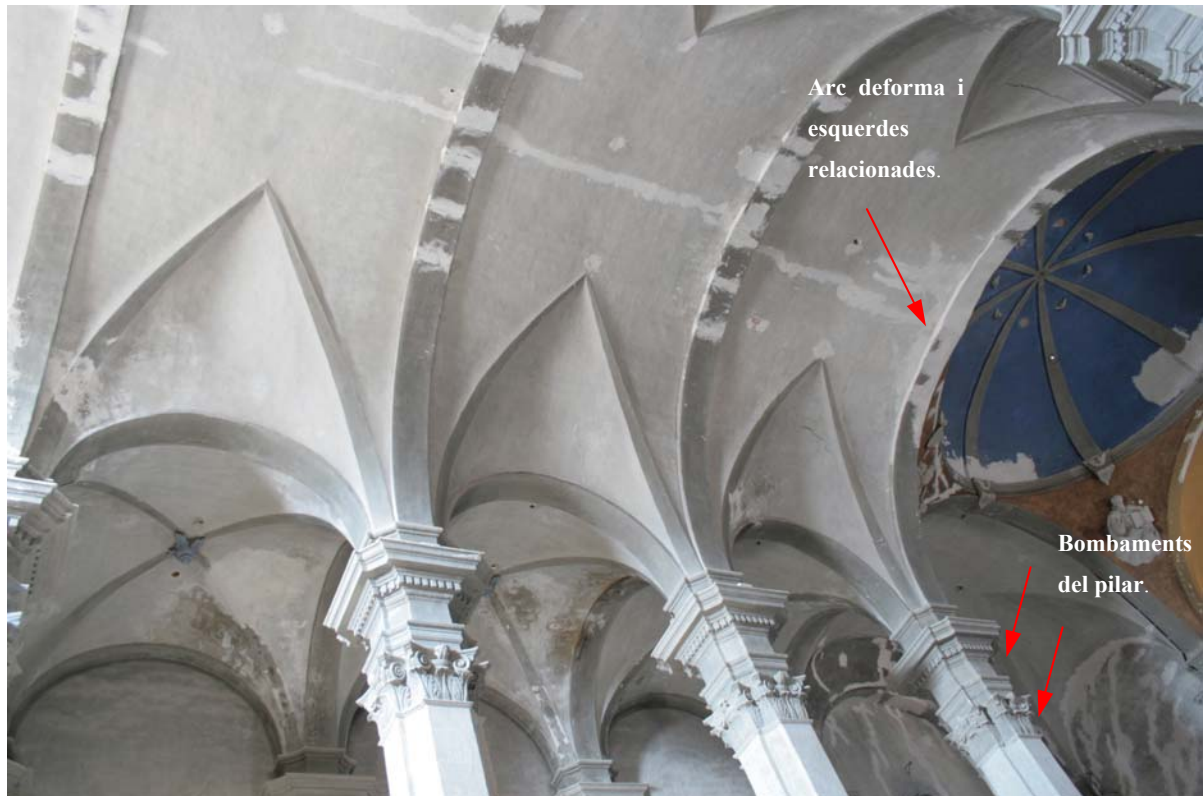
Fig.13 Esquerdes i humitats a les voltes i arcs de la nau. S'aprecia l'arc més deformat i les esquerdes derivades.
