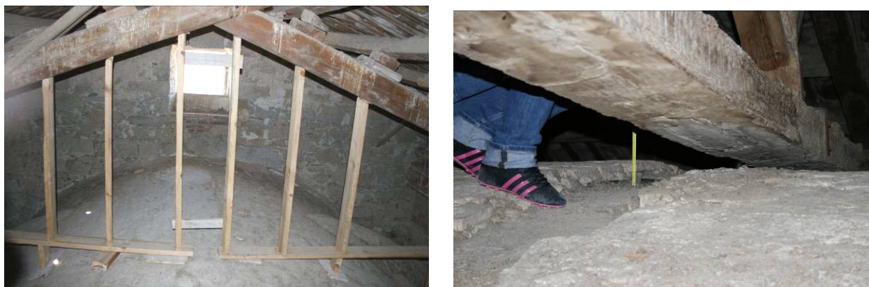
Fig.27 Apuntaments de les bigues sobre les voltes i separació de la volta respecte l'arc des de l'extradós, a causa de la deformació més pronunciada de l'arc.
