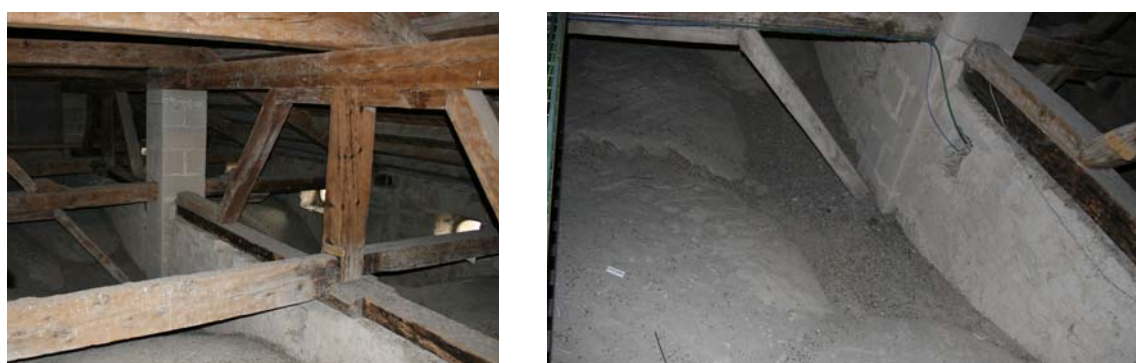
Fig.4 Tornapuntes a l'extradós de la coberta de la capella de la Universitat de Cervera. 1718-40.
