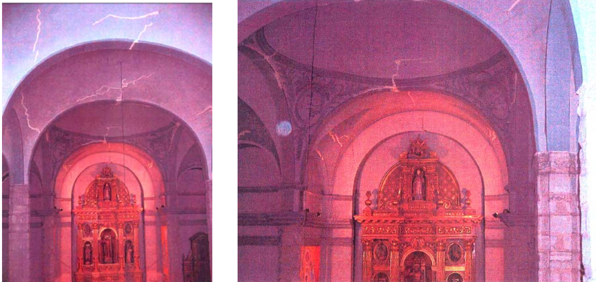
Fig.6 Fotografies de les lesions exteriors de l'església. Font: Sala Consultors SL, 2006. Facilitat per l'arquitecte Ramón Padullés
