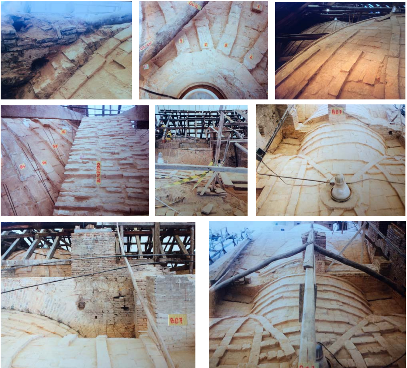
Fig.7 Fotografies de les voltes durant el desmuntatge de la coberta. Els treballs van comportar la catalogació de tots els elements.
