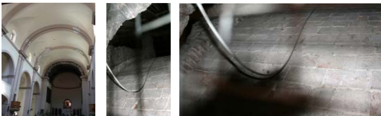
Fig.8 Interior de l'església de Cornudella de Montsant i vistes de l'extradós de les voltes a la catalana que la cobreixen. Es poden distingir perfectament els maons. Maig de 2014.
