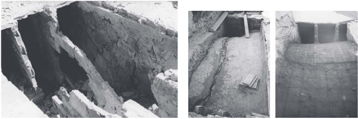
Fig.13 Envanets de sostre mort originals sobre les voltes de rajola doblada a l'església d'Albatera. A la dreta la reforma del 96. Font: PÉREZ-SÁMCHÉZ, JC., PIEDECAUSA-GARCÍA, B., PÉREZ-SÁNCHEZ, VR., MORA-GARCÍA, RT., 2015. La construcción de sistemas abovedados en la iglesia de Santiago Apóstol de Albatera (Alicante).
