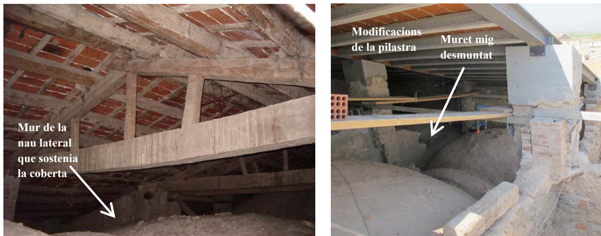
Fig.35 A l'esquerra la fotografia de l'estat previ a la rehabilitació mostra el muret on recolza la coberta. A la dreta, la fotografia durant l'execució de l'obra mostra el muret mig desmuntat i les modificacions evidents a la pilastra, que denoten que possiblement ja s'havia realitzat intervencions a la coberta que n'havien augmentat l'alçada. Fotografia cedida per Ramon Padullés.
