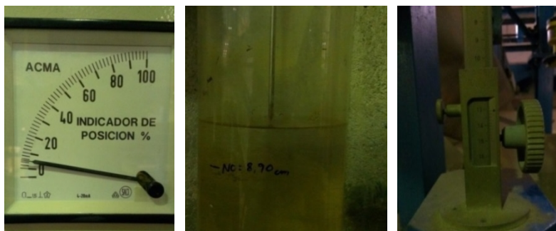
Figura IV-25. Indicador de abertura de la compuerta y nivel y lectura de limnómetro
