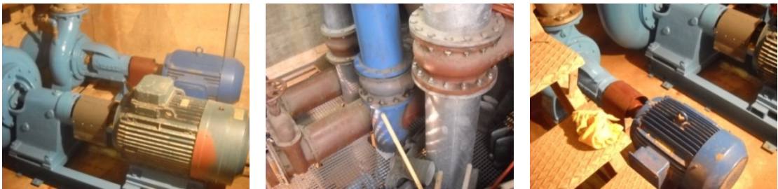
Figura III-7. Interior de la estación de bombeo del laboratorio
