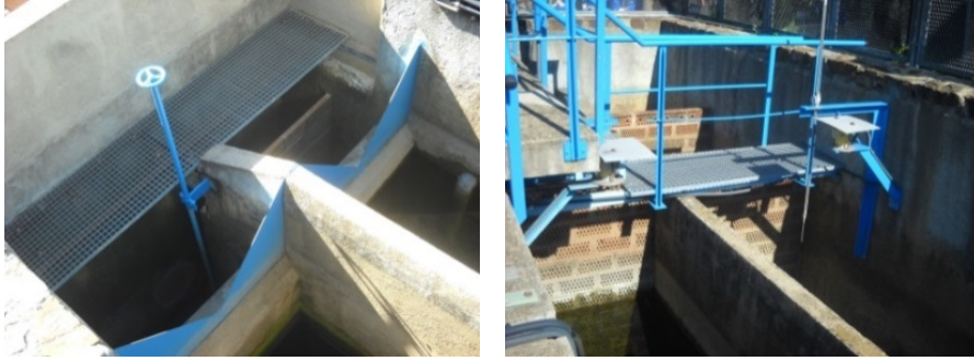
Figura III-8. Depósito de nivel constante (izquierda), vertederos triangulares (centro) y zona de lectura mediante limnímetros (derecha)
