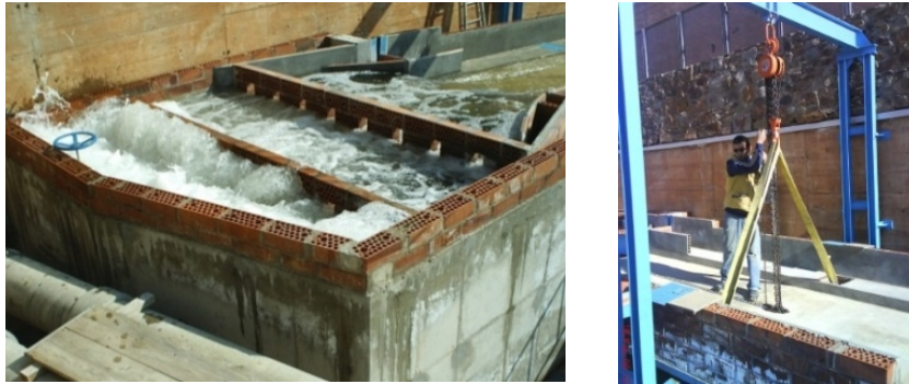
Figura II-24. Depósito de cabecera a la izquierda y modificación de la pendiente longitudinal de la plataforma a la derecha
