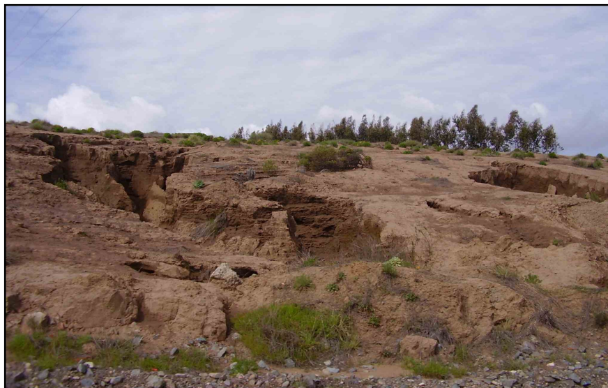
Figura 52. Erosión en cárcavas en sectores descubiertos camino a la localidad de Los Maitenes. 1,5 km de la Fundición.
