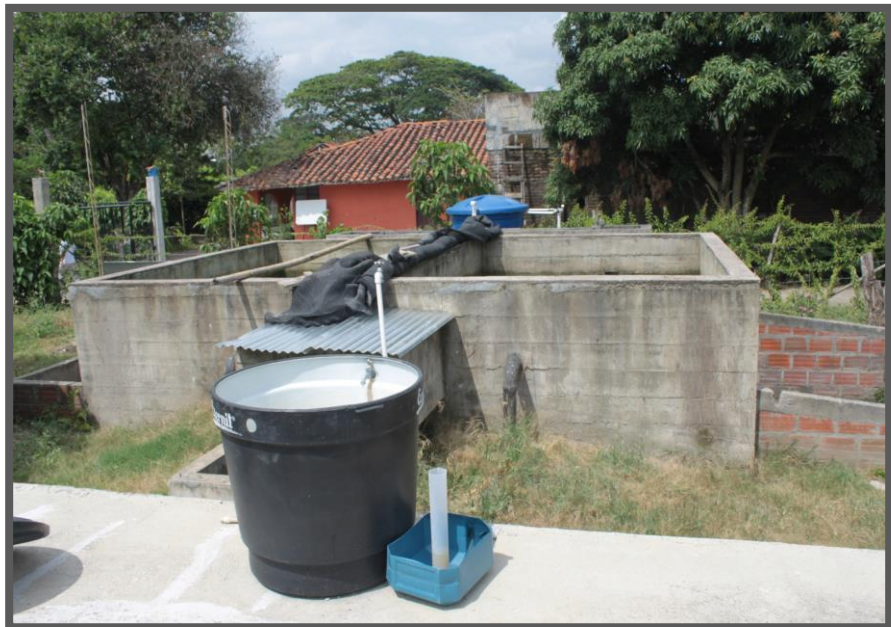
Proyecto comunitario de codesarrollo (planta potabilizadora de agua para proyecto de vivienda colectiva) en una ecoldea de mujeres, 2012, Valle del Cauca, Colombia.
