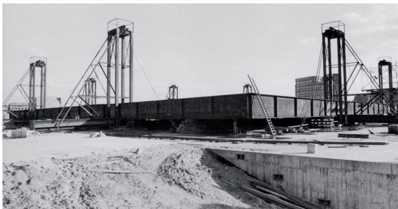
F.17 La cubierta, a 1,20 metros del suelo durante la fase de montaje.
