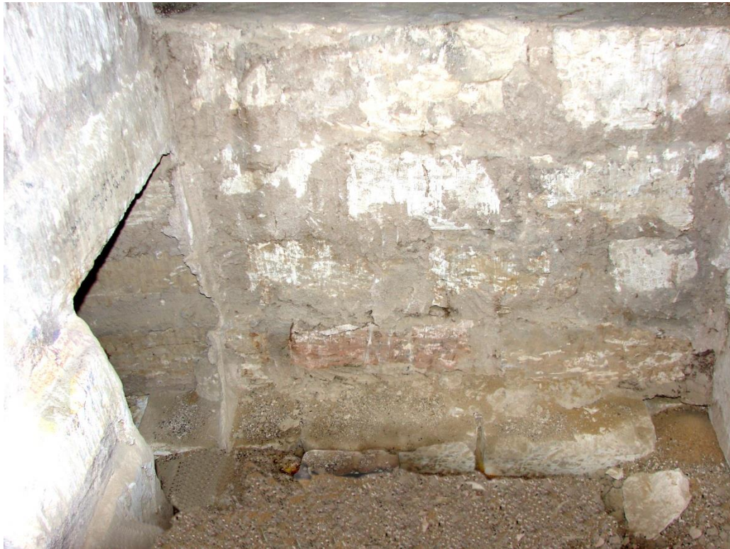
Fig. 66. Mur (U.E.15055) de tanca de la primera fase de la galeria1A, entre els nínxols 29 i 30.
