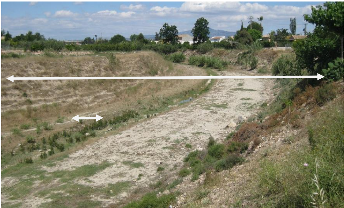
Figura 2.64. Cauce del Río Mula entre Las Torres de Cotillas y Alguazas, paraje de la Torre del Obispo. Cerca de la desembocadura al Río Segura.
