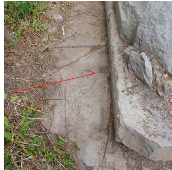
Foto 294: Agujero del gozne de la puerta del edificio de Quevedo
