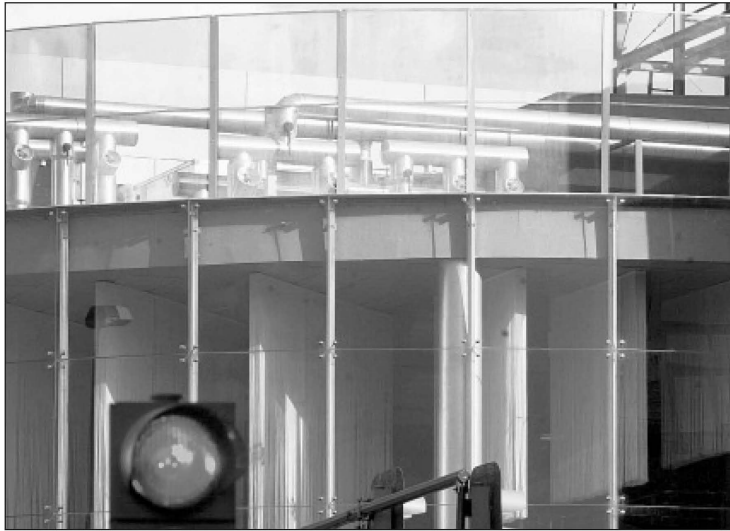
Conducciones del aire acondicionado y torres de refrigeración del centro de ocio Zig Zag.
