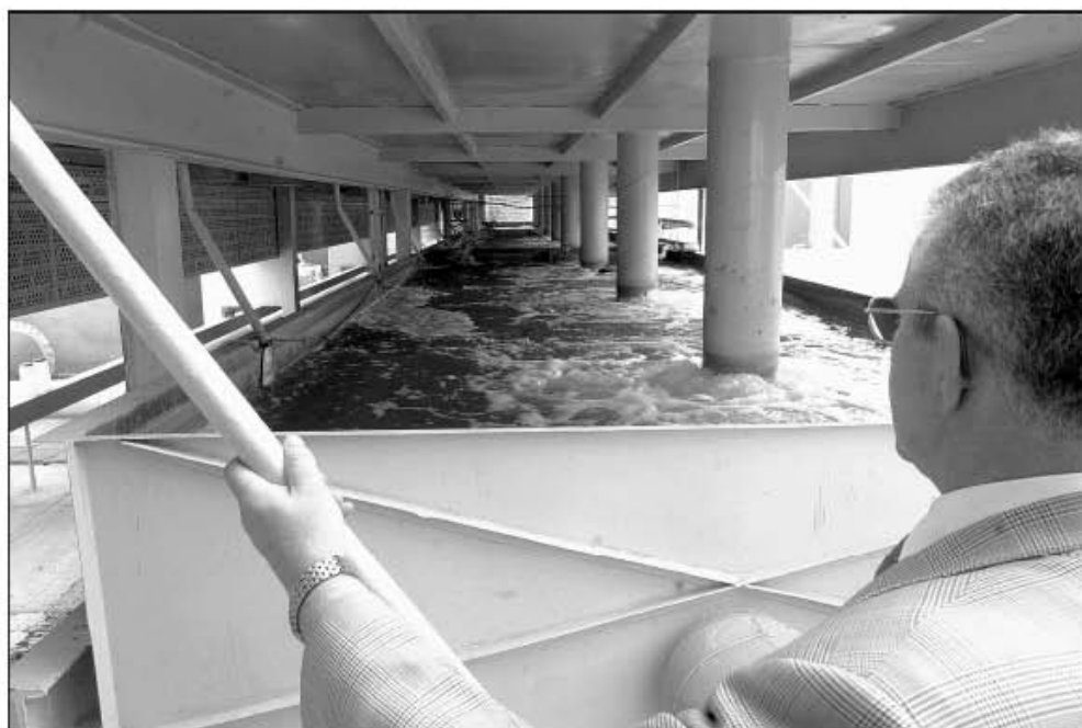
Perspectiva tomada el lunes de las balsas de agua situadas en la base de las tres torres de refrigeración de El Corte Inglés. En la última de ellas se halló legionella.
