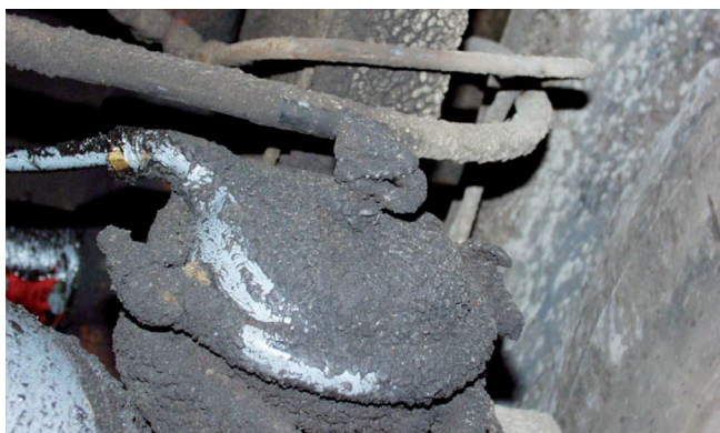
Figura 13: Toma de presión deteriorada
