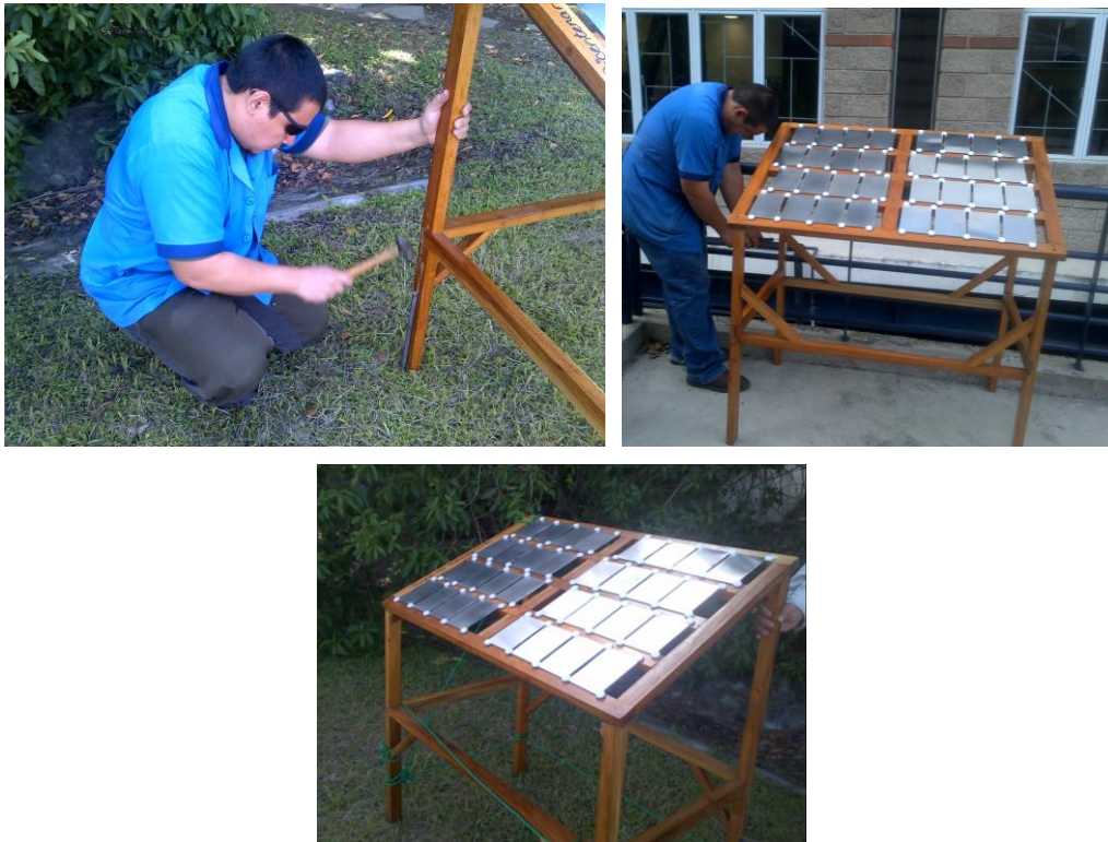
Figura 4.32 Racks siendo sujetos y asegurados en los sitios de monitoreo
