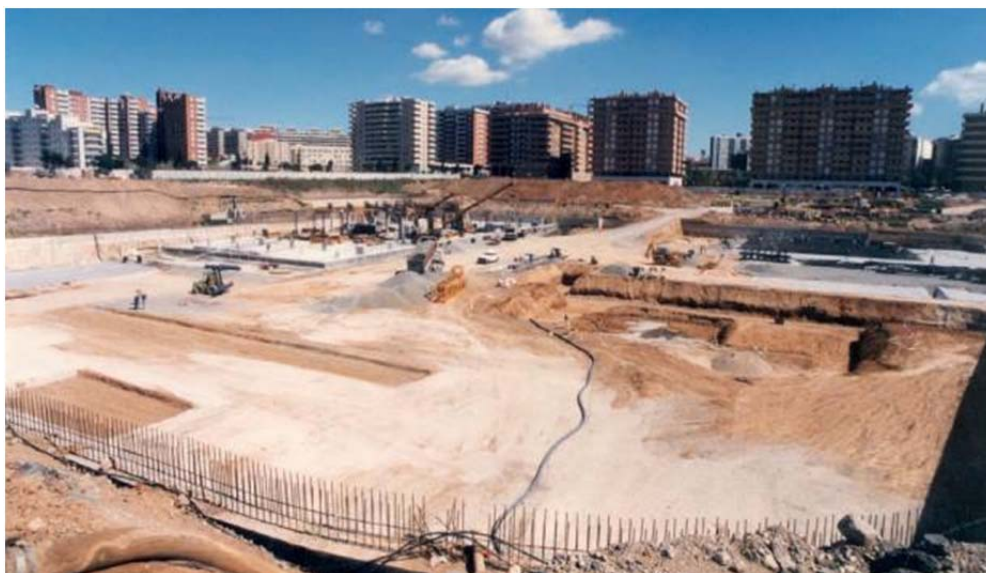
Imagen 26: Obras del Parc Central, pelotazo activador de una nueva zona de crecimiento.
