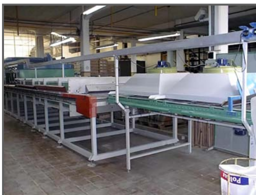
Pantallas enfriadoras por aire a la salida del horno. (Fábrica Vapahc , Argentina)
