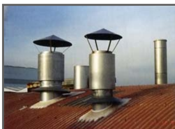
Silenciadores en chimeneas de hornos
